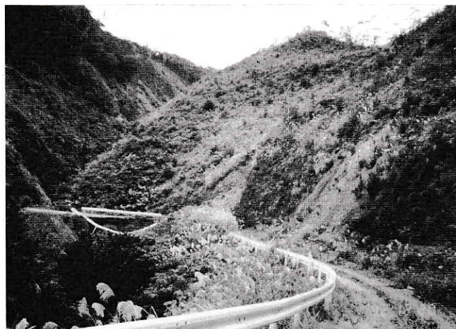
山崩れてガードレールまで壊された伊江川上流域 (1992 年撮影)
